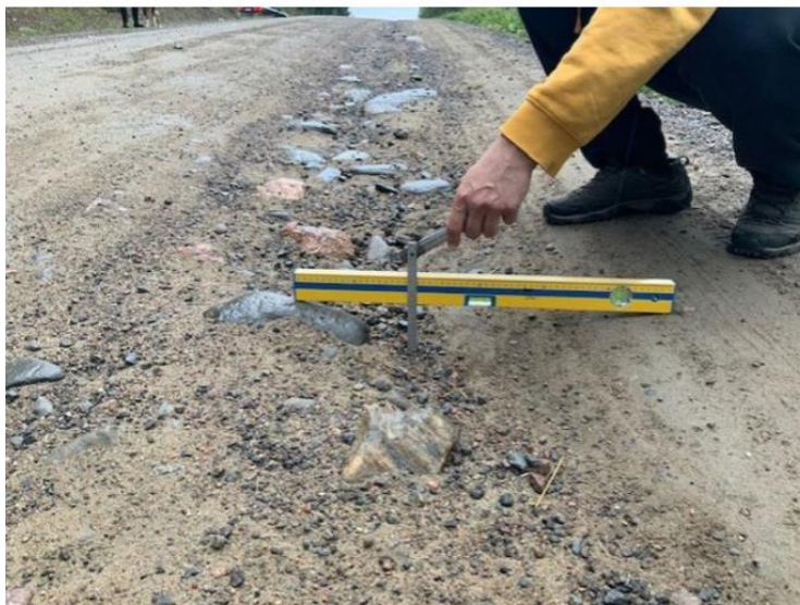
Tienpohjasta puskevat kivet rikkovat autoja Etelä-Savossa. Ongelma on laaja. LUKIJAN KUVA / HANNU SUMMANEN
